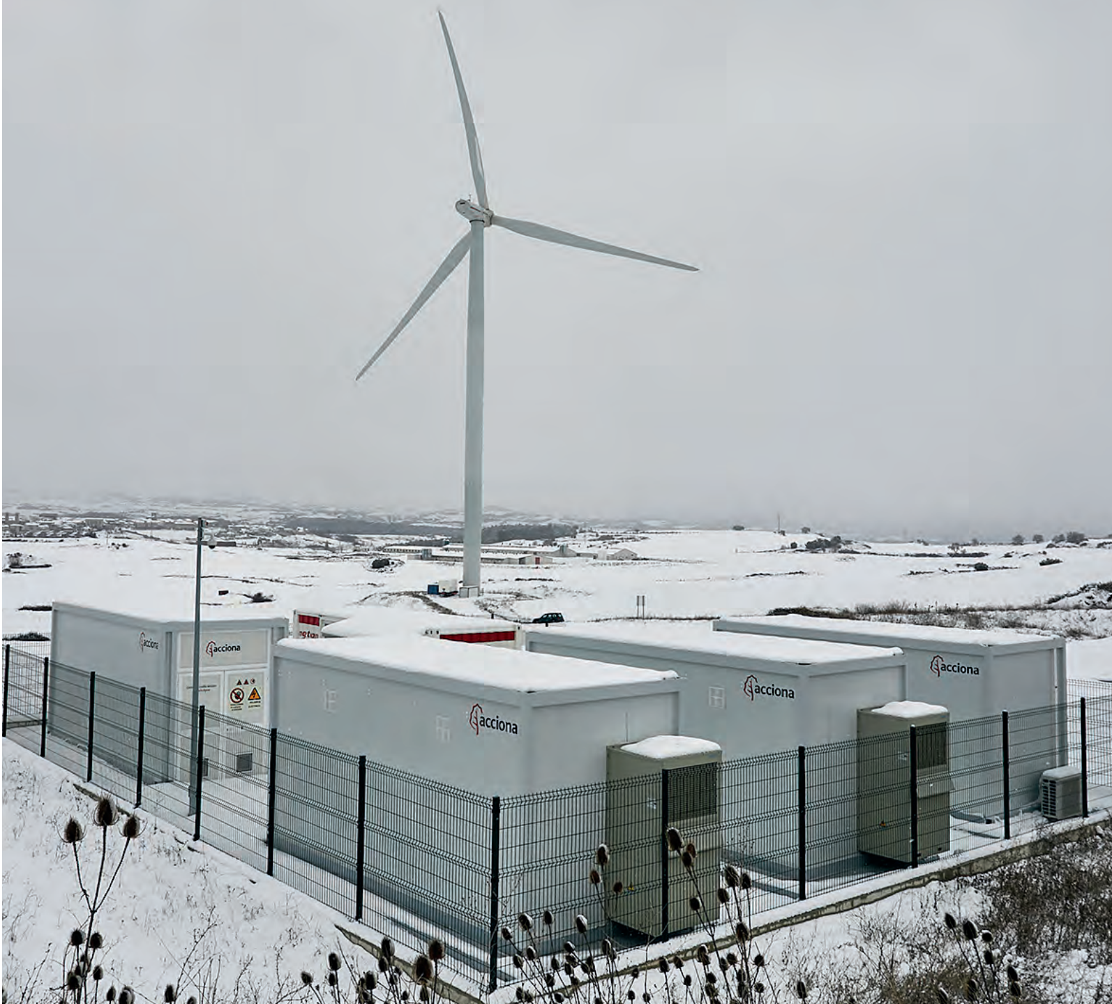
Planta de almacenamiento con eólica en Barásóain (Navarra)
