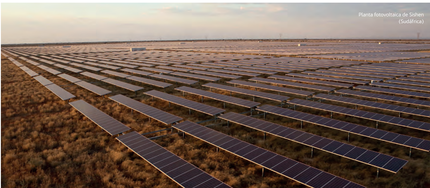
Planta fotovoltaica de Amareleja (Portugal)
