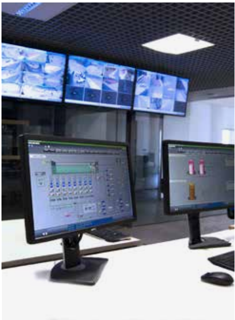
Centro de Control Desalinizadora Torrevieja Alicante. España
