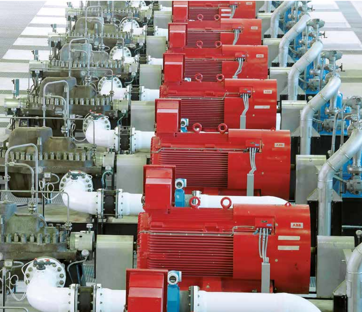
Planta desalinizadora de Alicante, España
