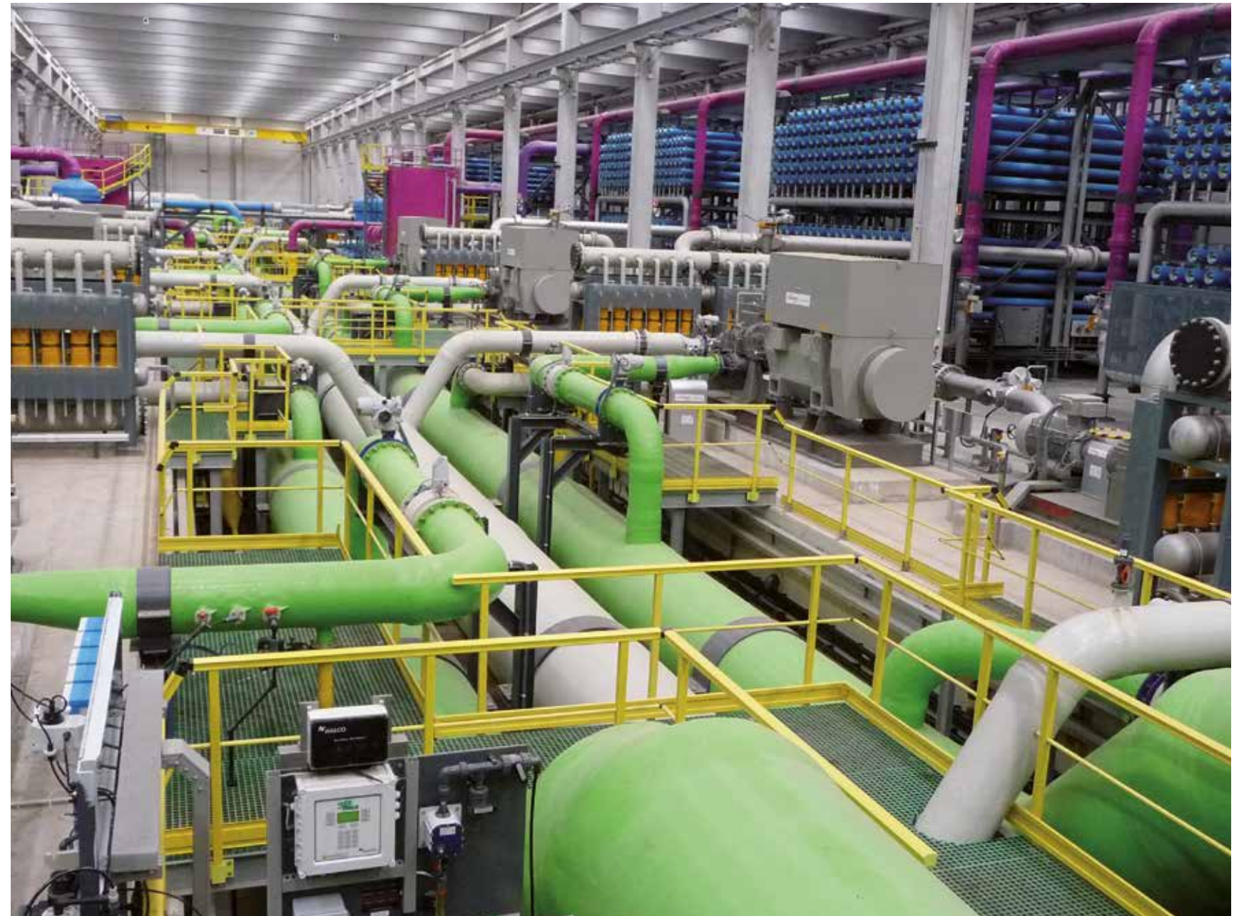
Planta desalinizadora de El Prat de Llobregat, Barcelona, España
