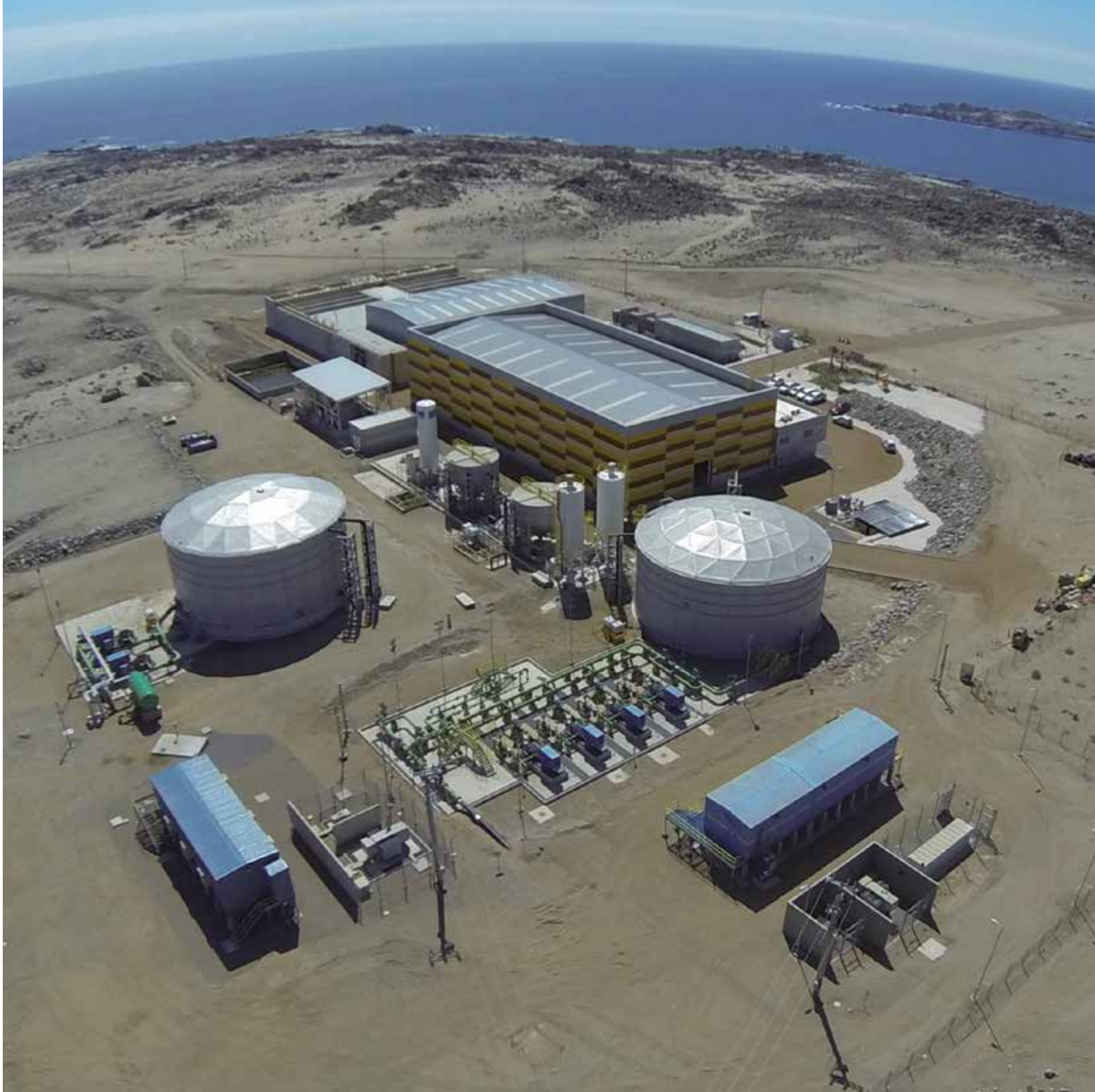
Planta desalinizadora de Copiapó, Chile
