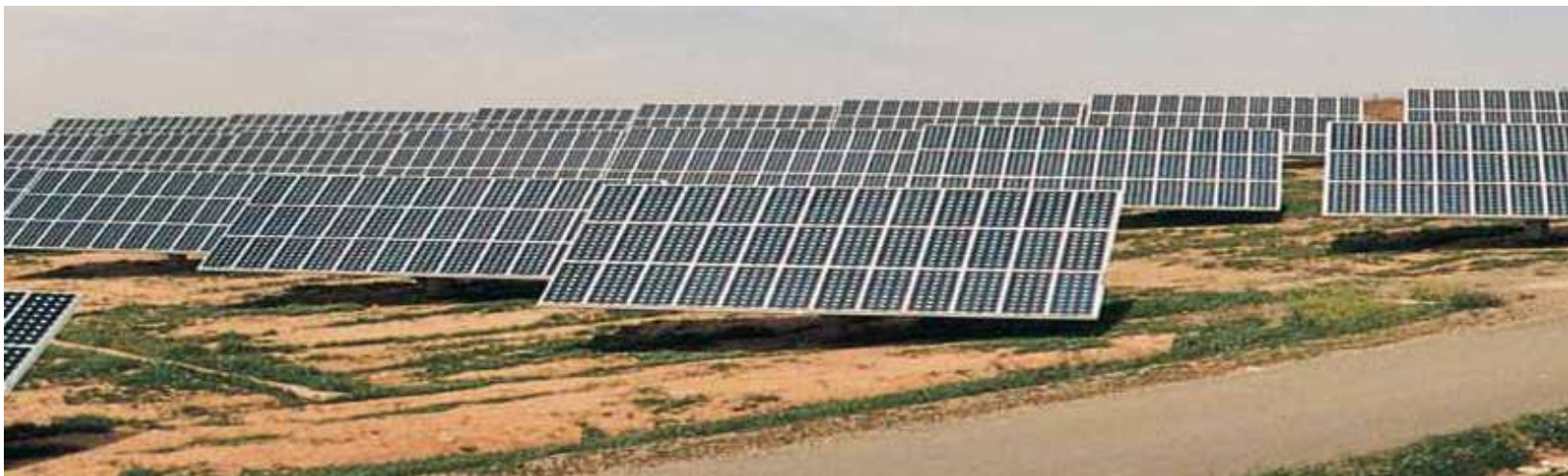
1,2MW Solar FV Planta en Tudela (España)
